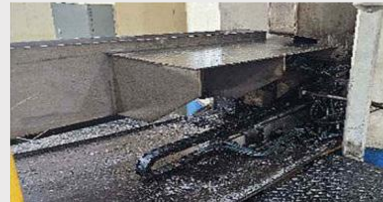
복잡한 설비 케이블 구조 노출에 따른 유지보수 비효율
