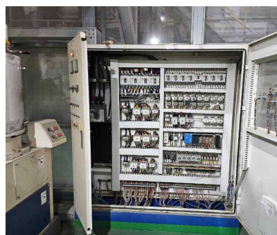
메인판넬 내부 전체 (메인 제어판넬 설치)
