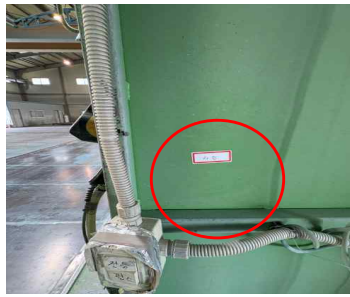
【예시】 (다른시설) 차압계 설치 위치
