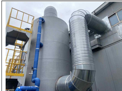
【예시】 방지시설명(용량) 흡수예의한시설(250) (시설 전체모습)
