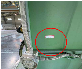
【예시】 (다른시설) 차압계 설치 위치
