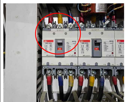
송풍 전류계 설치 위치
