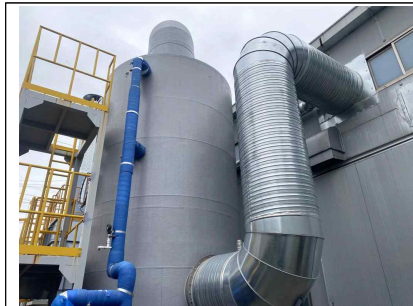
【예시】 방지시설명(용량) 흡수예의한시설(250) (시설 전체모습)
