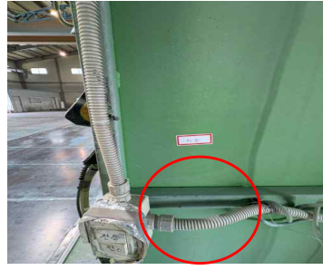
【예시】 (다른시설) 차압계 설치 위치
