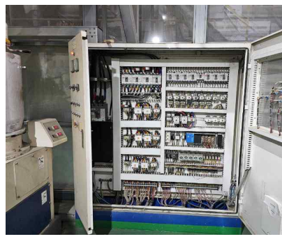
메인판넬 내부 전체 (메인 제어판넬 설치)
