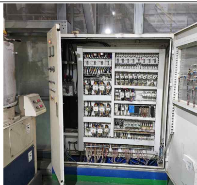
메인판넬 내부 전체 (메인 제어판넬 설치)
