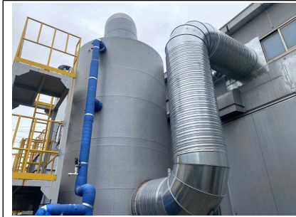
【예시】 방지시설명(용량) 흡수예의한시설(250) (시설 전체모습)
